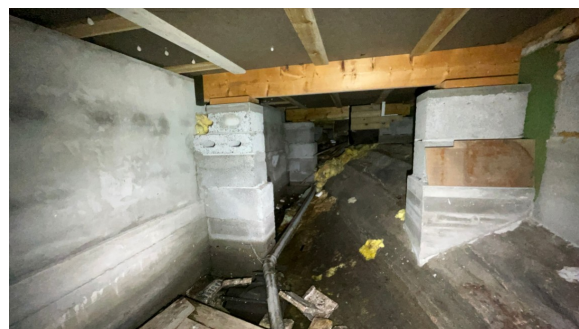
Fukt i krypkjeller.
