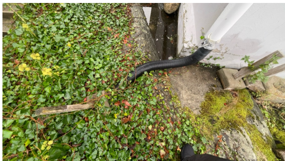
Drensrør i plast og stående vann.
