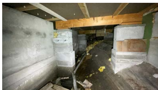
Fukt i krypkjeller.
