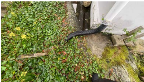
Drensrør i plast og stående vann.
