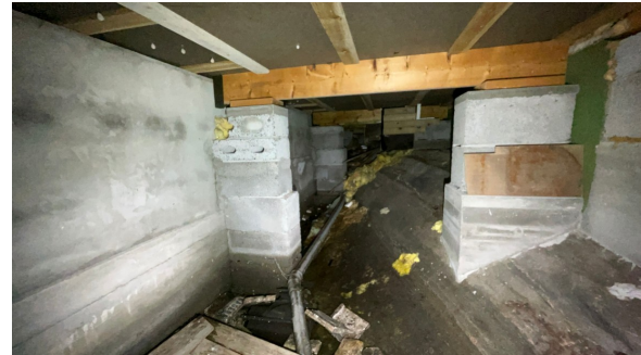
Fukt i krypkjeller.
