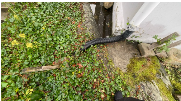
Drensrør i plast og stående vann.
