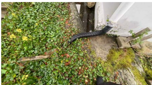
Drenerør i plast og stående vann.
