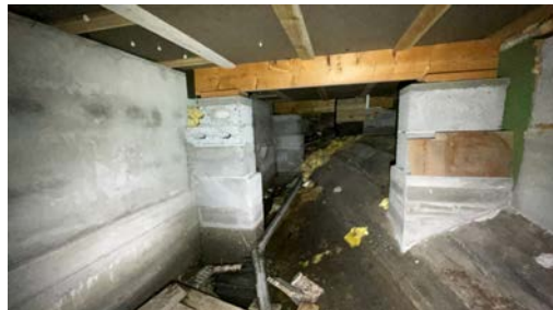
Fukt i krypkjeller.
