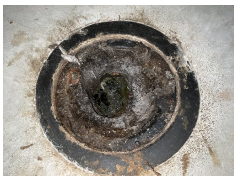
Støpejernssluk i vaskerom .
