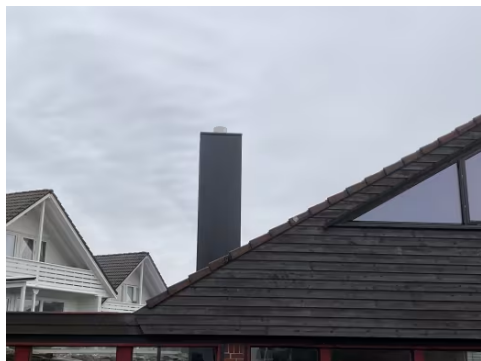
Trinn på pipe er ikke montert.
