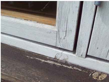
Noe vedlikehold må beregnes.
