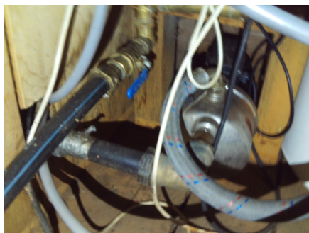
Vannpumpe i isolert rom under hytta.
