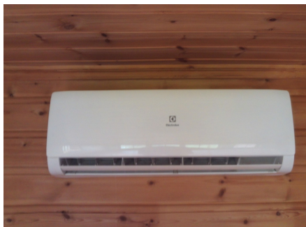
Varmepumpe i stue.
