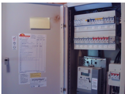
Sikringsskapet er plassert i gangen.
