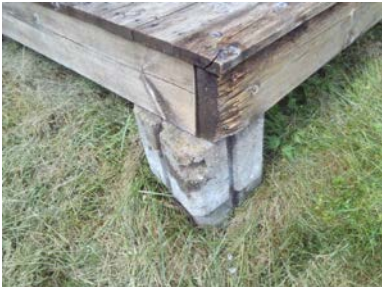
Noe sig i ene pilarer/fundamentering
