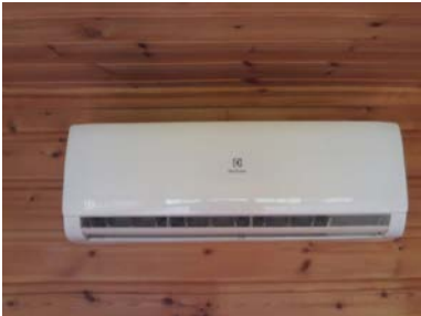
Varmepumpe i stue.
