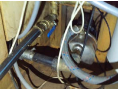
Vannpumpe i isolert rom under hytta.
