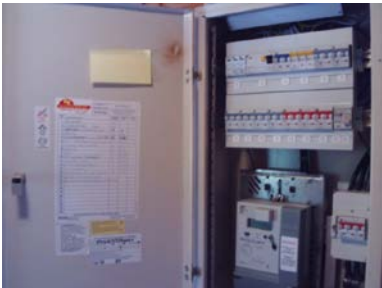
Sikringsskapet er plassert i gangen.
