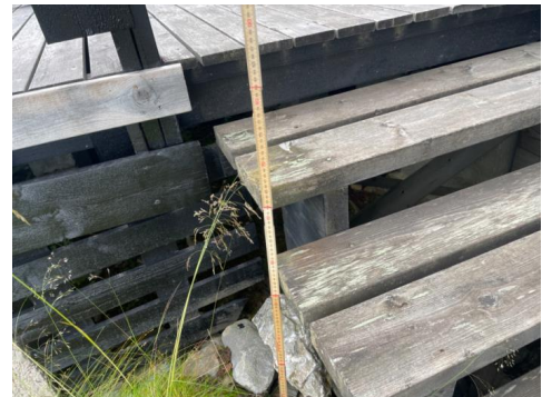
Rekkverk mangler i trapp
