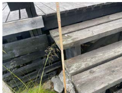
Rekkverk mangler i trapp
