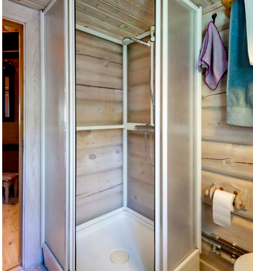
Det gjøres oppmerksom på at badet ikke er oppbygd som våtrom
