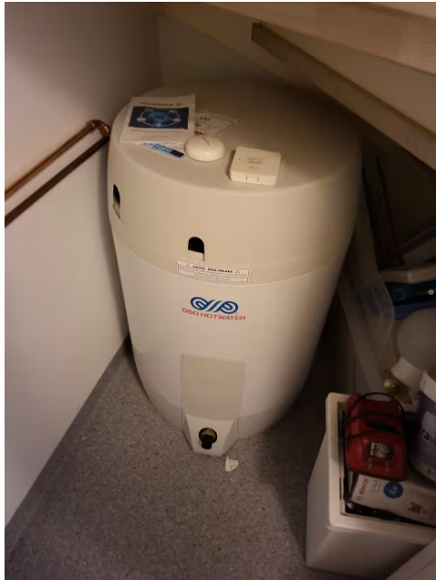
Varmtvannsbereder er plassert i bod under trapp.
