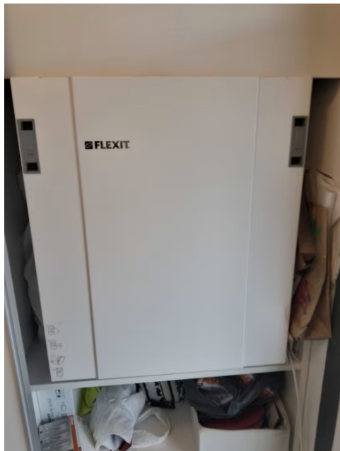
Ventilasjonsaggregat er plassert i garderobeinnredning tilknyttet entré.
