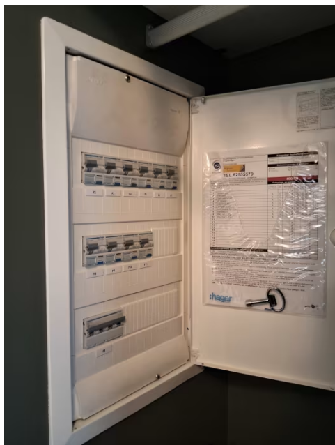
Sikringsskap er plassert i garderobeinnredning tilknyttet entré.
