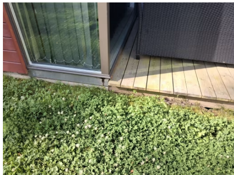
Hovedparten av grunnmur er ikke undersøkt på grunn av inntilliggende terrasser.
