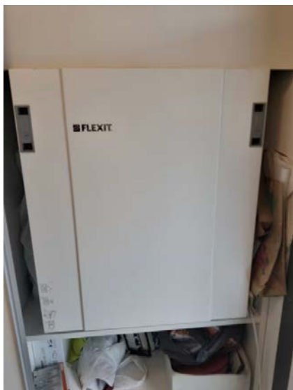
Ventilasjonsaggregat er plassert i garderobeinnredning tilknyttet entré.
