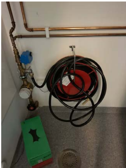
Boligen har husbrannslange plassert i bod under trapp.
