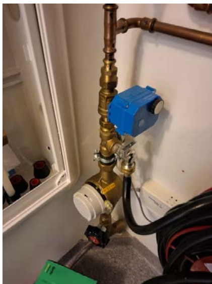
Hovedstoppekrane er plassert i bod under trapp.
