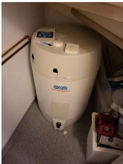
Varmtvannsbereder er plassert i bod under trapp.
