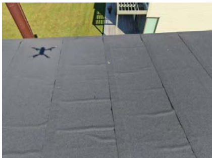
Det registreres buler og ujevnheter i taktekingen.
