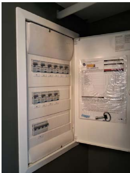
Sikringsskap er plassert i garderobeinnredning tilknyttet entré.
