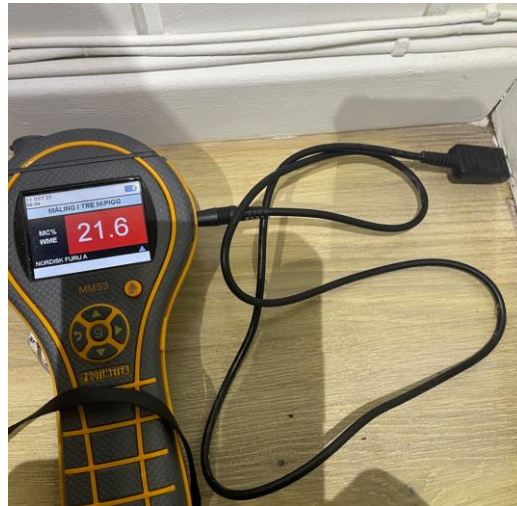
Fuktmåling under terreng stue u.etg
