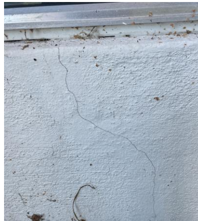
Riss/sprekkdannelser i grunnmur
