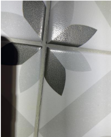
Riss i fug kjøkkenflis 1.etg
