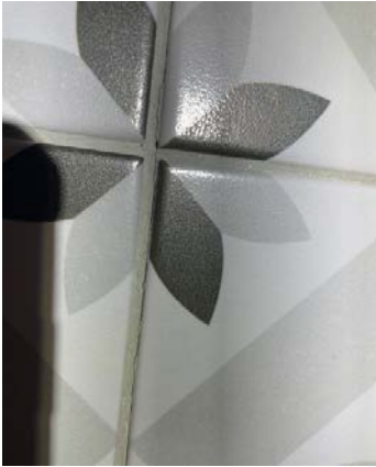
Riss i fug kjøkkenflis 1.etg
