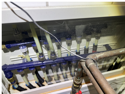
Rørskap i vaskerom.
