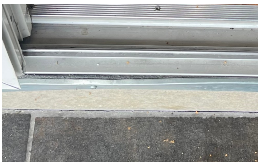
Skade på beslag under døren.
