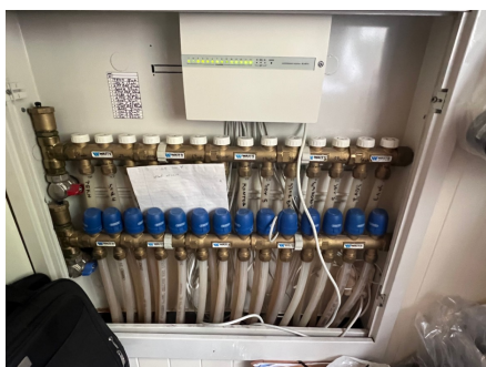
Rørskap- vannbåren gulvvarme.
