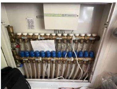
Rørskap - vannbåren gulvvarme.
