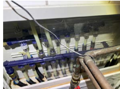
Rørskap i vaskerom.
