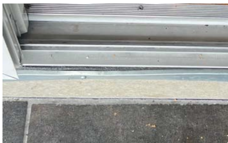
Skade på beslag under døren.
