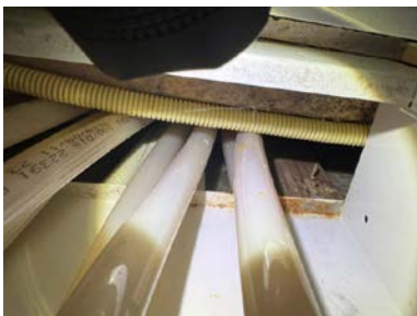
Ingen bunn i rørskapet
