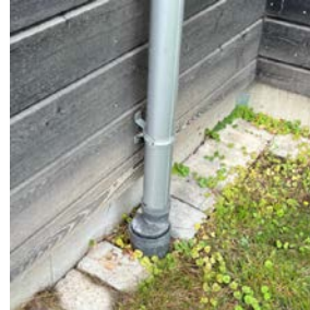
Taknedløp ned i rør/grunnen.
