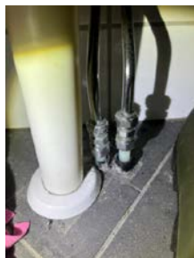
Ingen membransokkel på røroppstikk.
