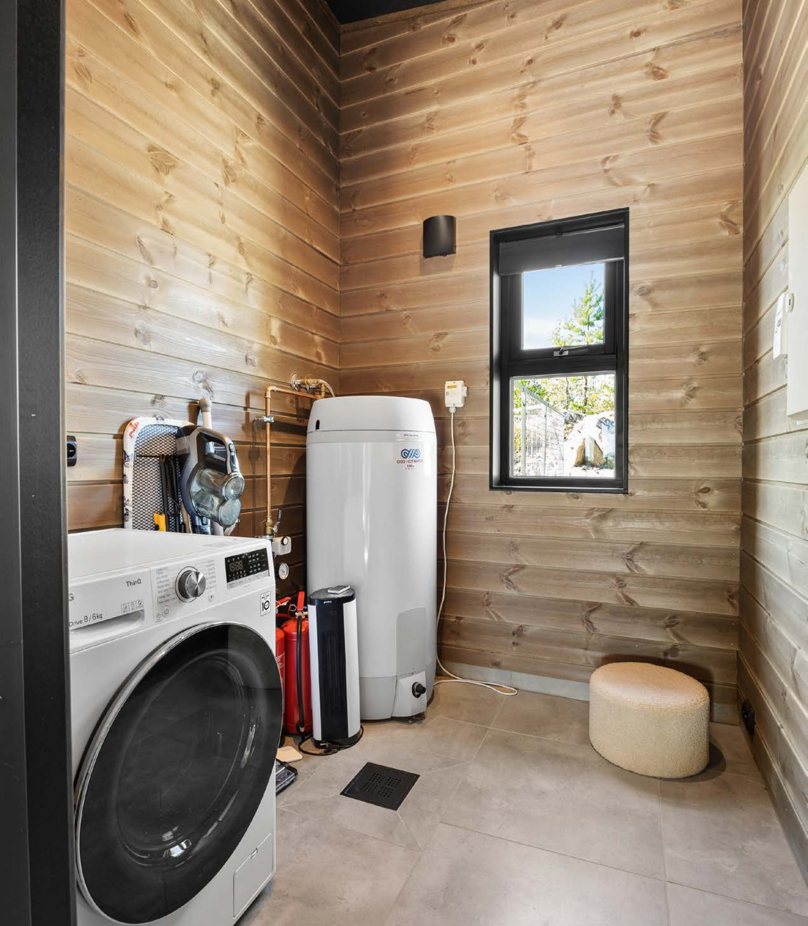
Vaskerommet har panelvegger, flislagt gulv med varme, varmtvannsbereder og opplegg for vaskemaskin.
