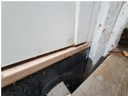
Noe swelling nederst på balkongdør.
