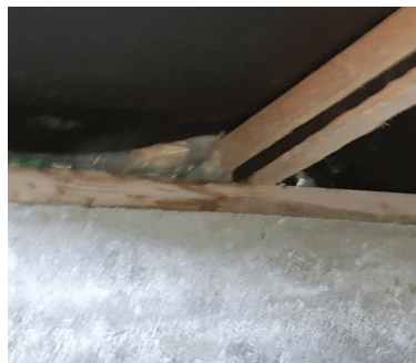
Det er brukt plast i stubtele.
