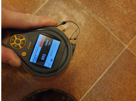
Fuktsøk på gulv 568 (vått)
