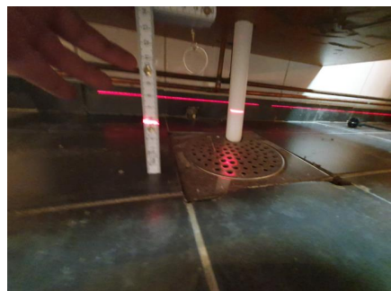
5,5cm ved siden av sluk.
