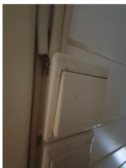
Ikke overdekning av ledning ved bryter
