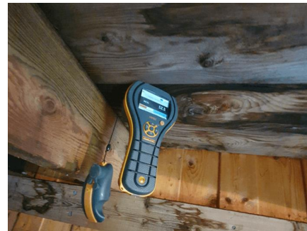
Fuktmåling fra garasjen i trobord viser høyt fuktinnhold 52,3V%
