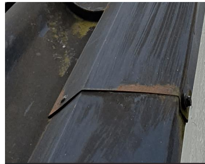
Rust på overgangsbeslag
