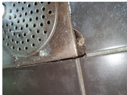
Skade i flis ved rist
