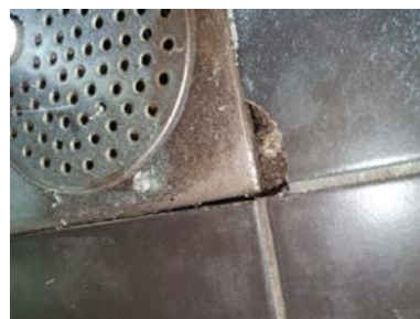
Skade i flis ved rist
