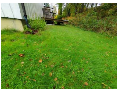
Fall inn mot grunnmur
