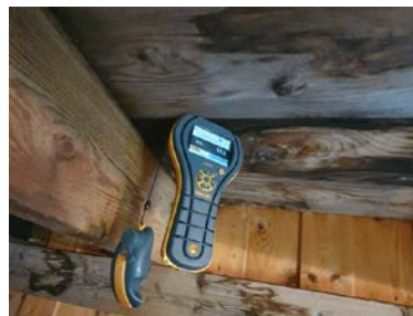
Fuktmåling fra garasjen i trobord viser høyt fukttinnhold 52,3V%
