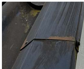
Rust på overgangsbeslag
