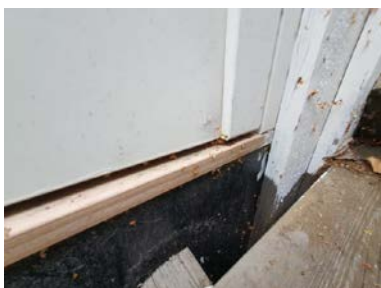
Noe svelling nederst på balkongdør.
