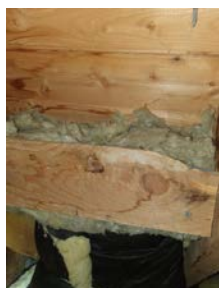
Det er påvist avvik rundt gjennomføringer i takflaten.
