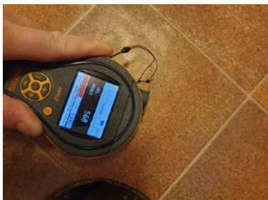
Fuktsøk på gulv 568 (vått)
