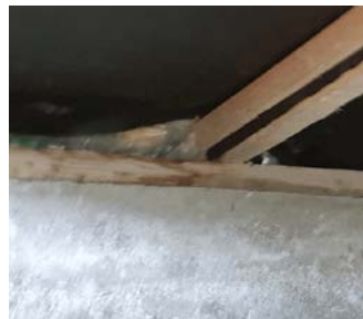
Det er brukt plast i stubtele.
