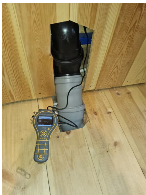
Bilde viser fuktmåling mot bad på teknisk rom.
