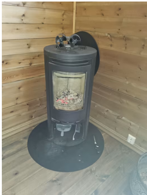
Bilde viser vedovn i stue.
