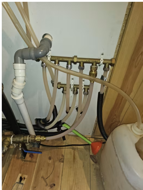
Bilde viser åpen rørfordeling.
