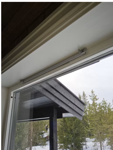
Bilde viser luftespalte i vindu.
