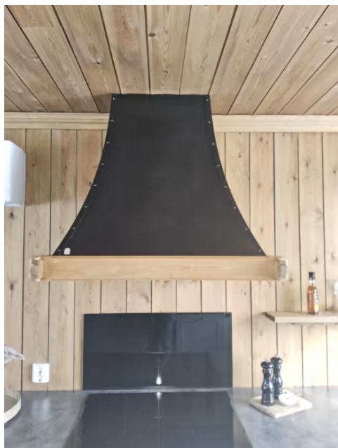
Bilde viser kjøkkenventilator.
