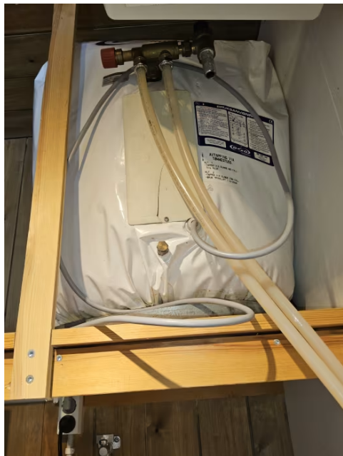
Bilde viser varmtvannsbereder.
