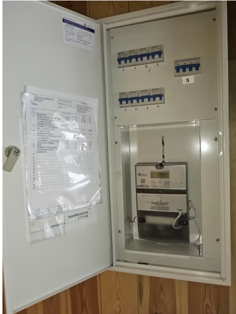
Bilde viser sikringsskap.
