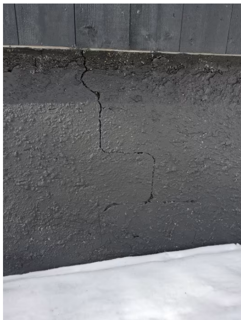
Bilde viser riss/sprekk i grunnmur.
