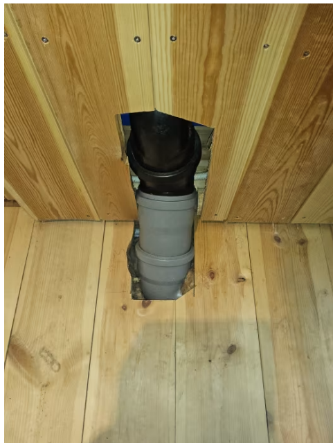
Bilde viser avløpsrør fra toalett.
