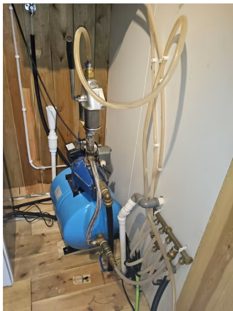
Bilde viser vannpumpe.
