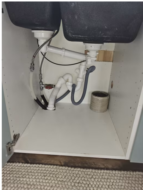
Bilde viser røropplegg under oppvaskkum.
