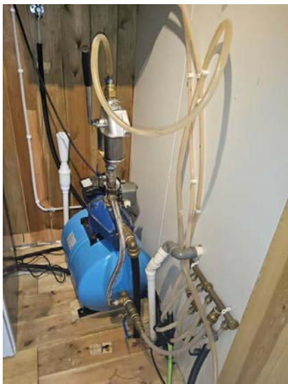
Bilde viser vannpumpe.
