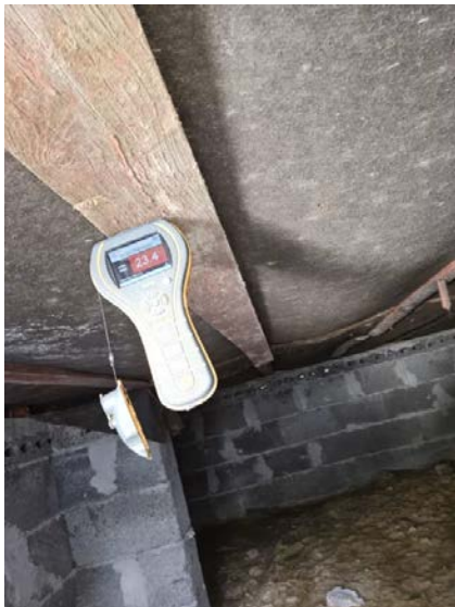
Bilde viser fuktmåling i krypkjeller.
