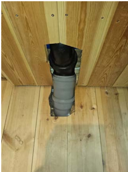
Bilde viser avløpsrør fra toalett.
