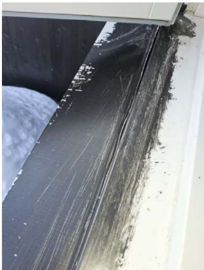
Bilde viser ufagmessig utførelse av vannbrettbeslag.
