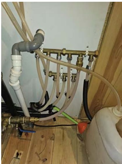
Bilde viser åpen rørfordeling.
