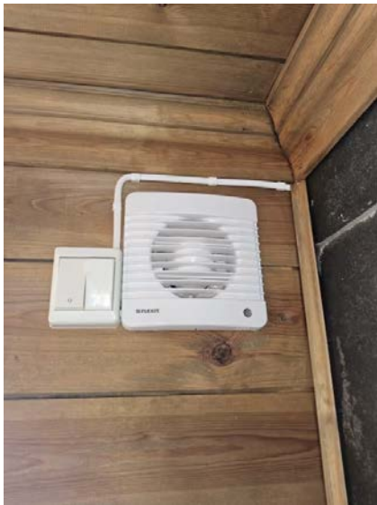
Bilde viser avtrekksvifte på bad.
