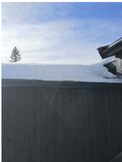
Bilde viser snødekt tak.
