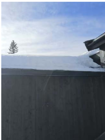
Bilde viser snødekt tak.
