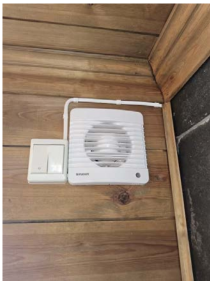
Bilde viser avtrekksvifte på bad.
