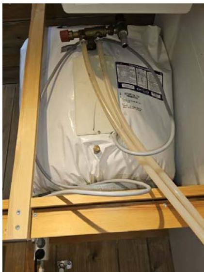
Bilde viser varmtvannsbereder.
