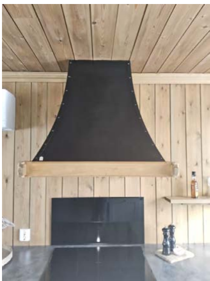
Bilde viser kjøkkenventilator.
