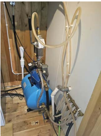
Bilde viser vannpumpe.
