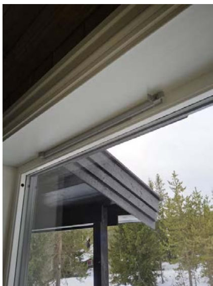
Bilde viser luftespalte i vindu.
