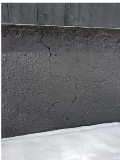
Bilde viser riss/sprekk i grunnmur.
