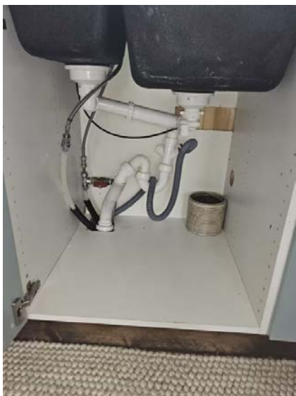
Bilde viser røropplegg under oppvaskkum.
