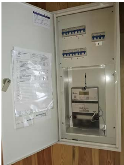
Bilde viser sikringsskap.
