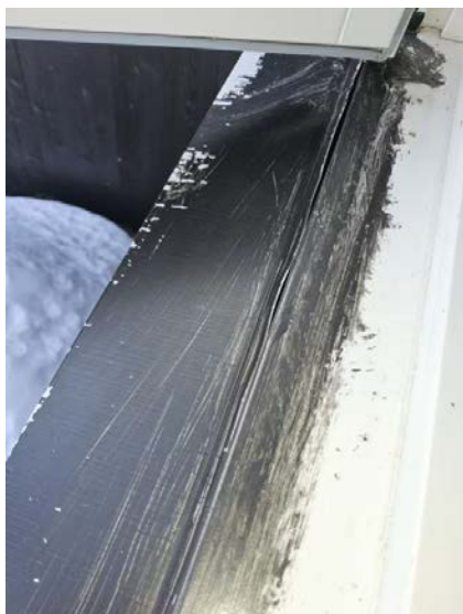
Bilde viser ufagmessig utførelse av vannbrettbeslag.
