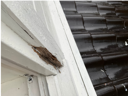
Råteskader på vinduene på loftet.
