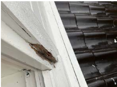
Råteskader på vinduene på loftet.
