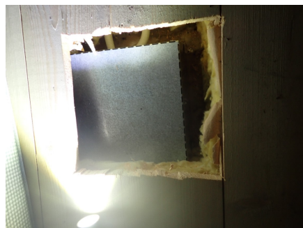
Løse spottkassetter, utettheter dampsperre.
