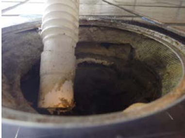
Plastsluk under dusjkabinett.
