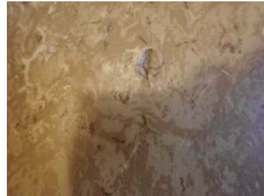
Skade i gulvbelegg.
