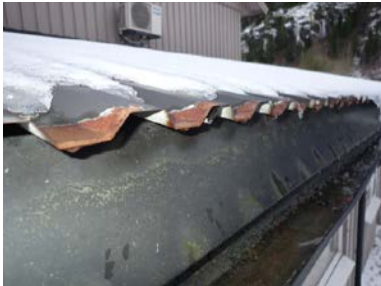
Rustmerker i takteking på tilbygget.
