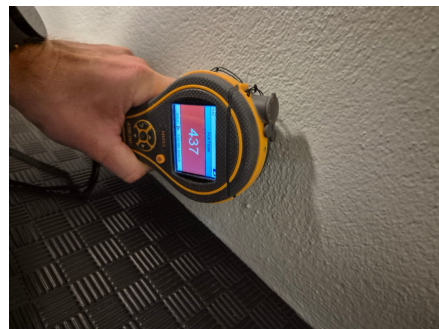
Det ble med fuktindikator registrert noe høye fuktverdier/fuktforskjeller på synlige murflater.
