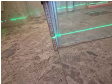
Helt flatt gulv fra ytterhjørne av dusjvegg...
