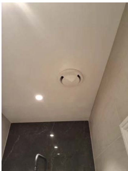
Avtrekkseffekten er testet med papir.
