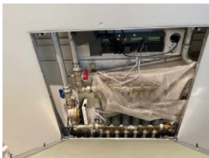
Fordelerskap for vannbåren gulvvarme er plassert i gang.
