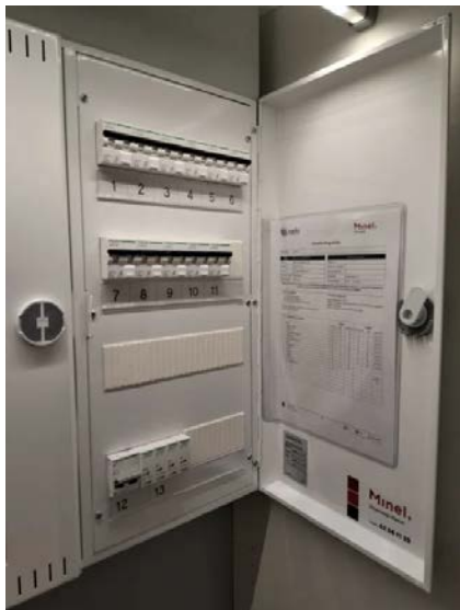
Sikringsskap med automatsikringer er plassert i entré.
