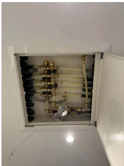
Fordelerskap for rør-i-rør med stoppekraner er plassert i himling på bad.
