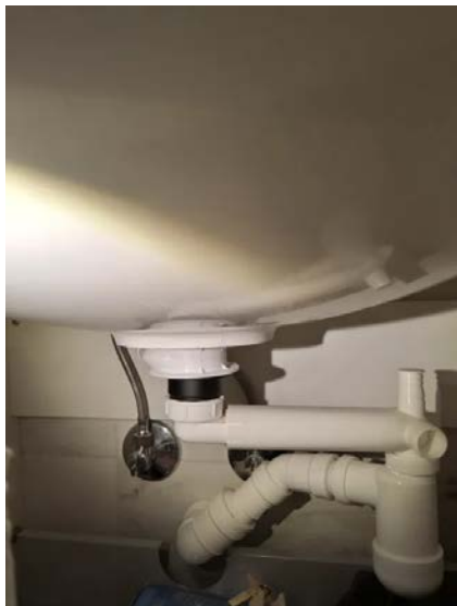
Leiligheten har synlige avløpsrør av plast.
