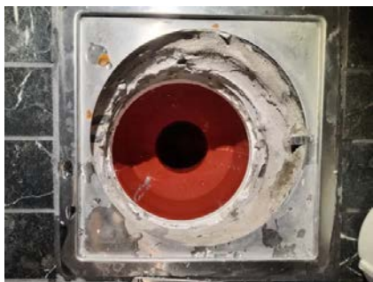
Overgang mellom sluk og membran er dekket av flislim.
