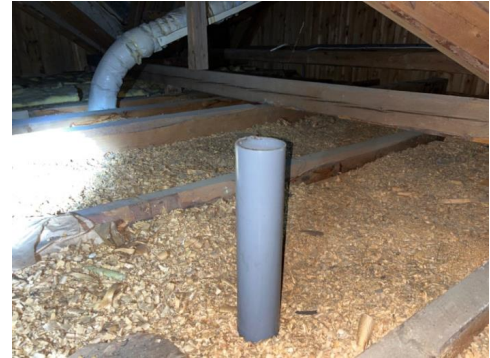
Lufterør avløp avsluttet på loft
