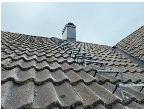
Slitt og mosegrodd takstein
