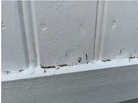
Råteskade i nedre kant av kledning.
