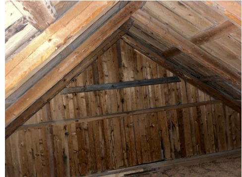
Manglende ventilering av kaltloft.
