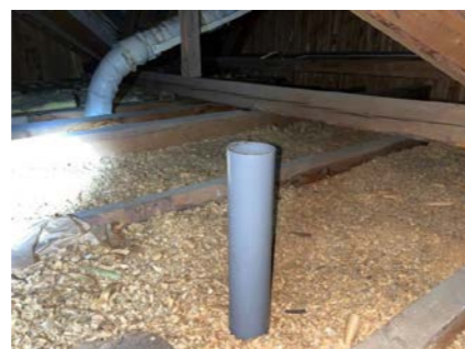
Lufterør avløp avsluttet på loft
