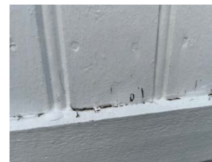
Råteskade i nedre kant av kledning.
