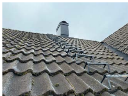
Slitt og mosegrodd takstein
