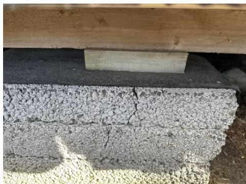
Det registreres sprekker i fundamenter.
