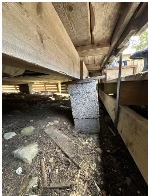
Lecapilarer ved opprinnelig bygning med synlige skjevheter.
