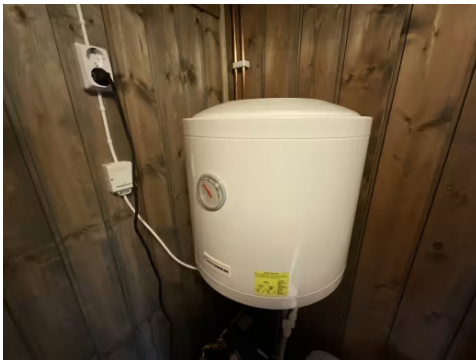
Viser veggghengt bereder på teknisk rom.
