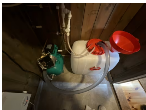
Viser vanntank og trykkpumpe på teknisk rom.
