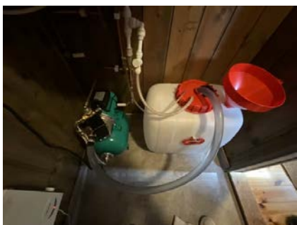
Viser vanntank og trykkpumpe på teknisk rom.
