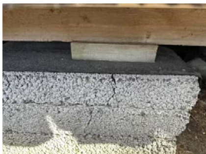
Det registreres sprekker i fundamenter.
