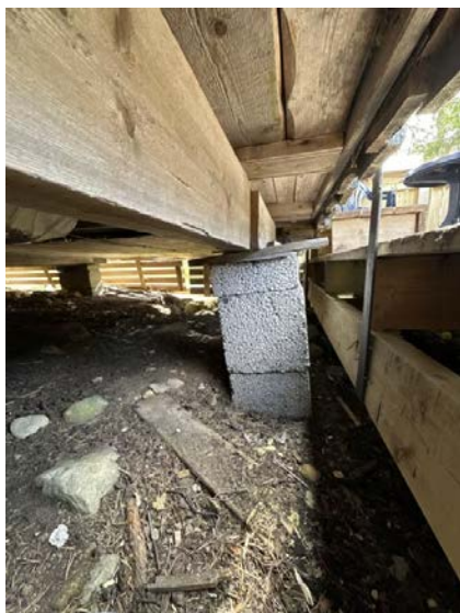
Lecapilarer ved opprinnelig bygning med synlige skjevheter.
