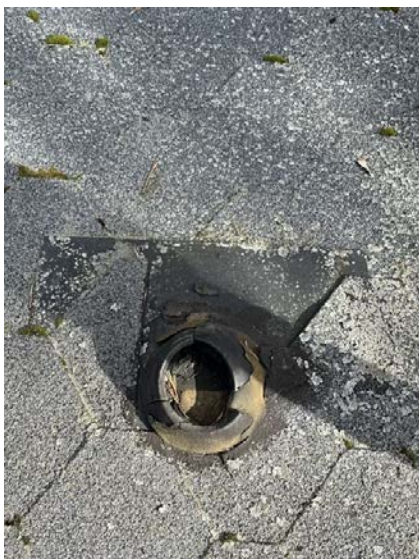
Eldre taggjennomføring som ikke er i bruk anbefales fjernet.
