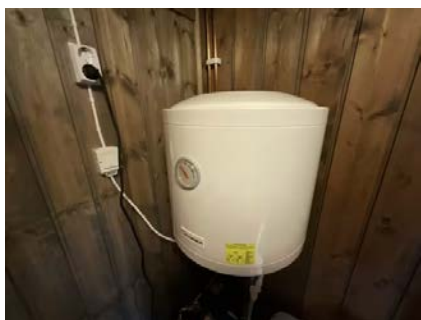
Viser vegghengt bereder på teknisk rom.
