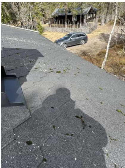
Det er registreres svikt nedbøy i takflaten nedenfor pipe.
