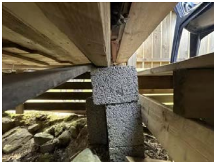
Lecapilarer ved opprinnelig bygning med synlige skjevheter. Det registreres åpninger i stubbloft.
