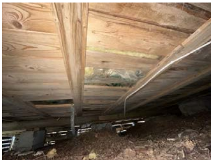
Det registreres åpninger i stubbloft.
