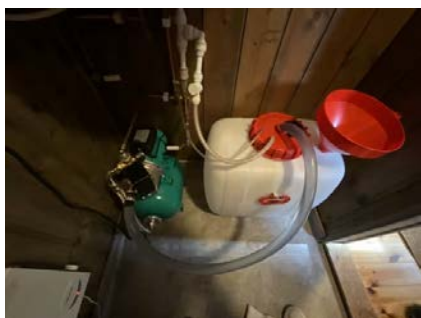
Viser vanntank og trykkpumpe på teknisk rom.
