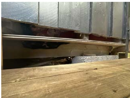
Det registreres åpninger i stubbloft.
