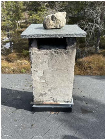
Viser pipe over tak.
