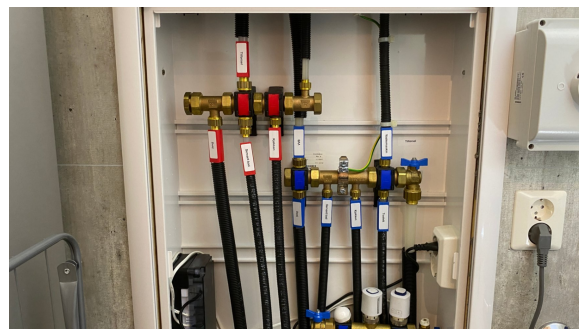
Kontroll av rørfordelerskap.
