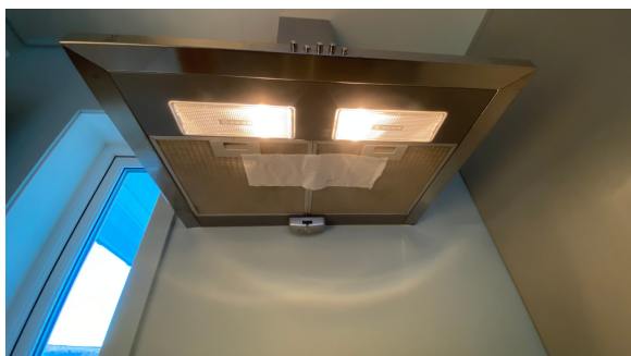
Kontroll av avtrekksvifte.
