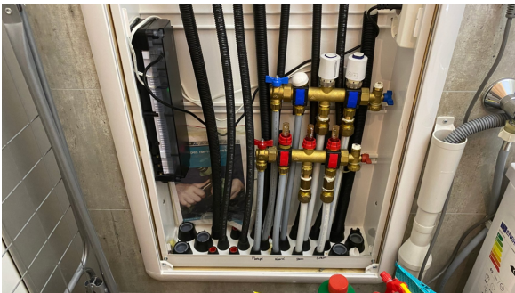
Kontroll av fordelingsskap.
