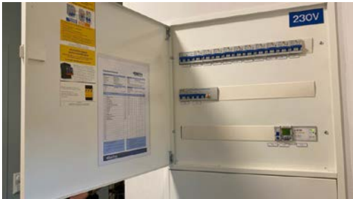
Kontroll av el-skap og kursfortegnelse.
