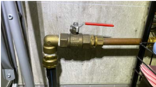
Kontroll av hovedstoppekran.
