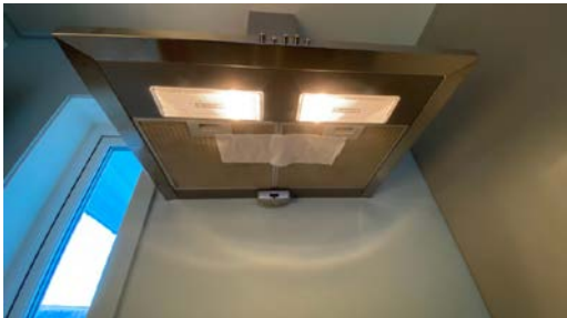
Kontroll av avtrekksvifte.
