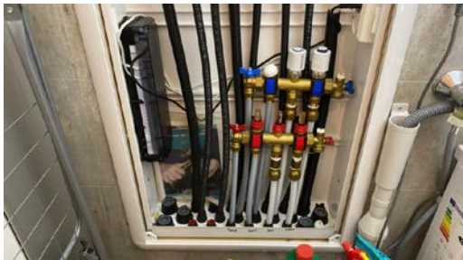
Kontroll av fordelingsskap.
