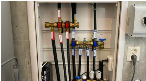
Kontroll av rørfordelerskap.
