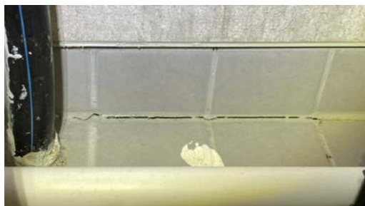
Sprekker i elastisk fug i overgangen mellom gulv/vegg.
