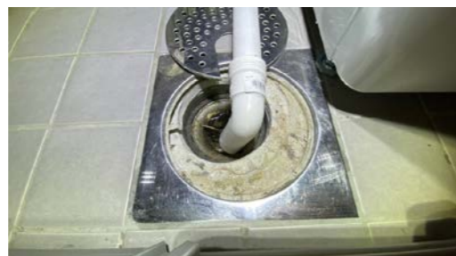
Kontroll av sluk i skyvedørgarderobe.
