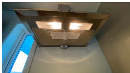
Kontroll av avtrekksvifte.
