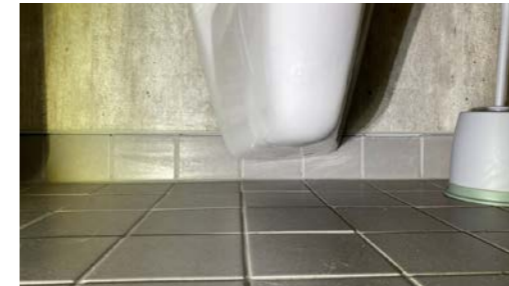
Spalte for synliggjøring av lekkasjevann mangler.
