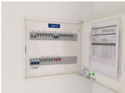
Sikringsskap plassert i gang.
