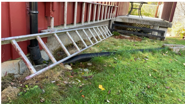
Ikke tilstrekkelig rør eller fall på bortledning av takvann
