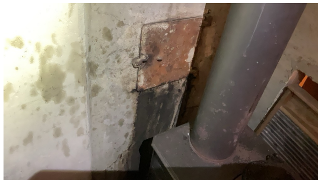
Rust på sotluke og avrenning fra luke tyder på fuktpåvirkning i pipeløp
