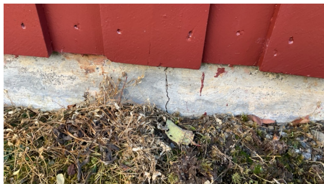
Sprekk i mur
