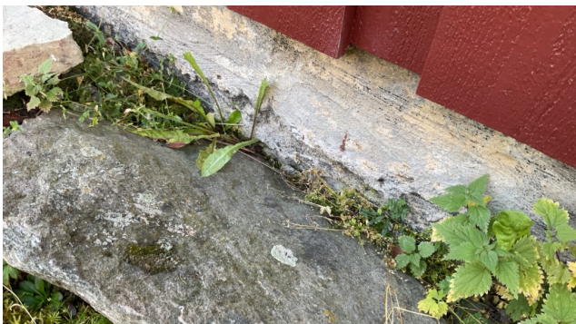
Sees forvitring på mur mot terreng
