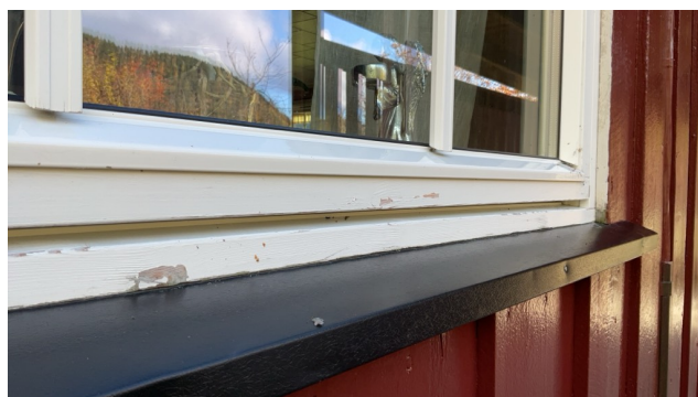
Det er registrert vedlikeholdsbehov
