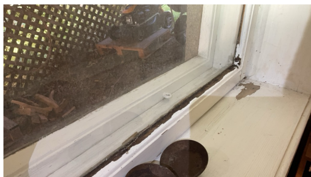
Koblede vindu er slitt og må påregnes utskifting
