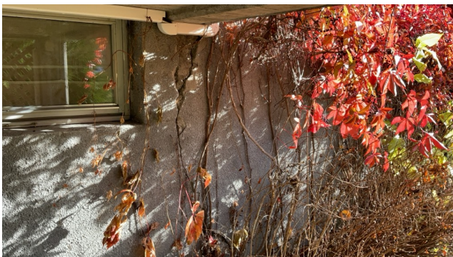
Sprekk i mur
