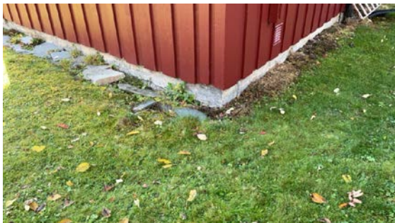
Terrengfall mot mur/bygning på oversiden og nord/vestlig retning
