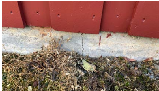
Sprekk i mur
