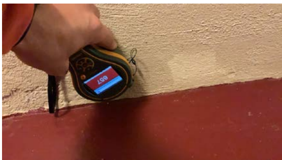
Ved overflatesøk med fuktmåler var det fuktutslag på murer mot terreng
