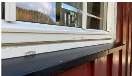
Det er registrert vedlikeholdsbehov
