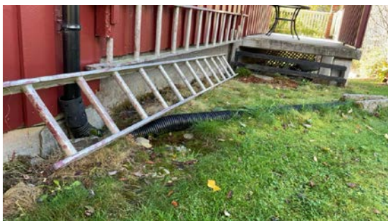
Ikke tilstrekkelig rør eller fall på bortledning av takvann
