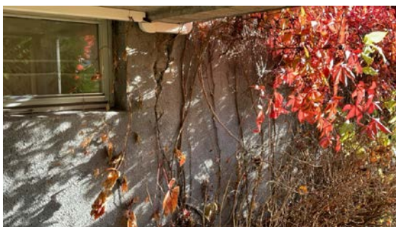
Sprekk i mur
