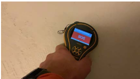
Ved overflatesøk med fuktmåler var det fuktutslag på gulv mot grunn
