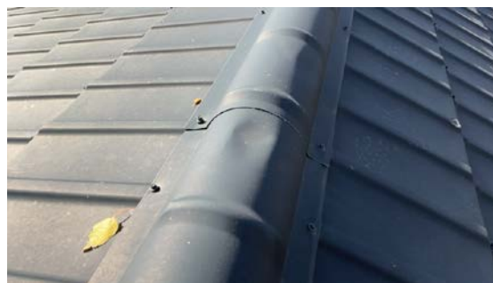
Kan sees stedvis nedtrødd plate, men ansees ikke med tiltaksbehov
