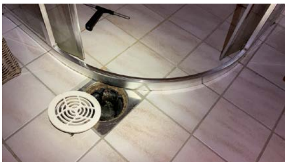
Fra sluk ble det ikke registrert tettesjikt i gulv/våtsoner Sluk er plassert utenfor dusj
