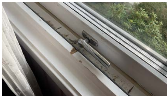
Må hensyntas alder og slitasje på eldste vindu
