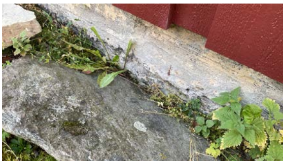
Sees forvitring på mur mot terreng
