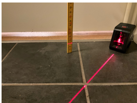
Ingen oppkant ved døren.
