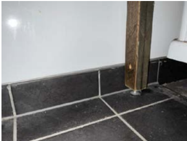
Mangler fug mellom plater og list
