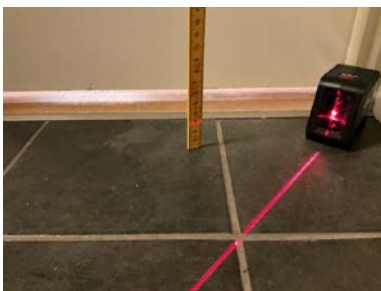
Ingen oppkant ved døren.
