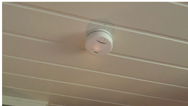
Røykvarsler i 1 etasje.
