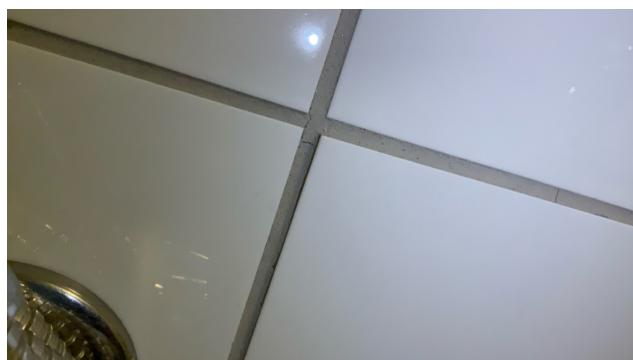
Riss/sprekker i flisfuger i våtsone.
