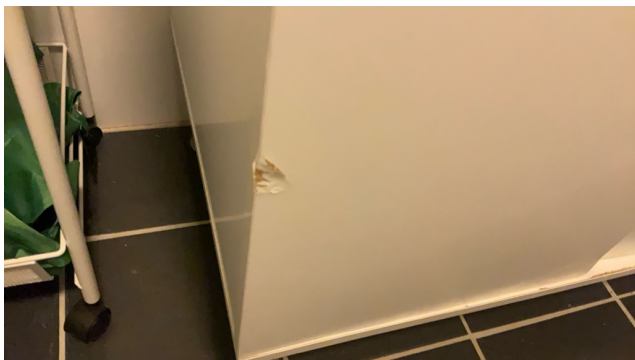
Skade på innredning.
