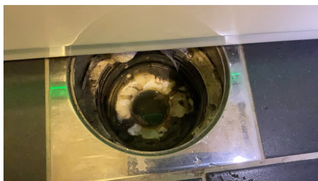
Plastsluk uten synlig slukmansjett under klemring.
