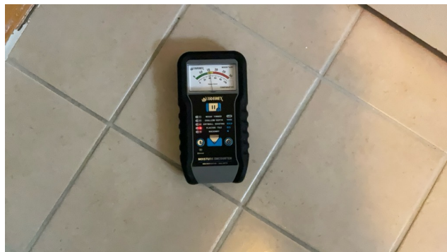
Fuktindikator gir ingen unormale resultater på gulv ved terskel.
