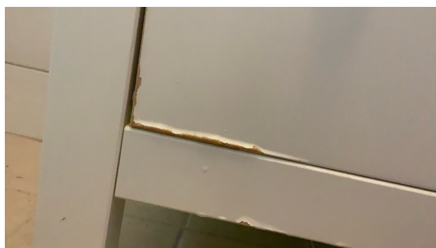
Eksempel på svelling i baderomsinnredning.
