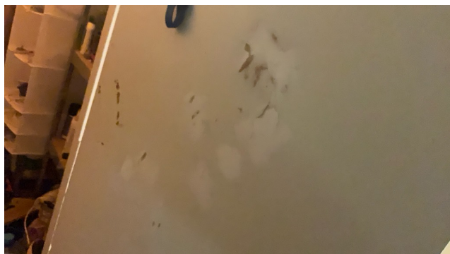
Skader på innerdør.
