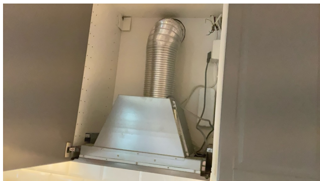
Ventilator med avtrekk ut.
