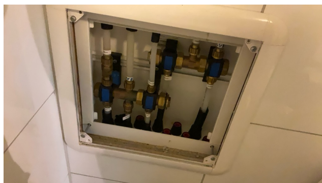
Besikket i fordelskap til vannrør.
