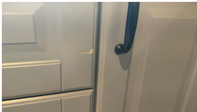
Skade på kjøkkenfront.
