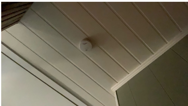
Røykvarsler i 2 etasje.
