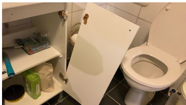
Dør på innredning defekt.
