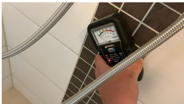
Fuktindikator gir ingen unormale resultater på vegg.
