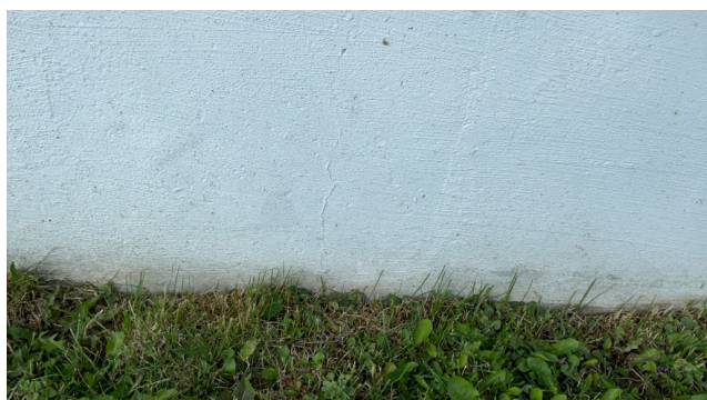
Eksempel på sprekkdannelser i grunnmur.
