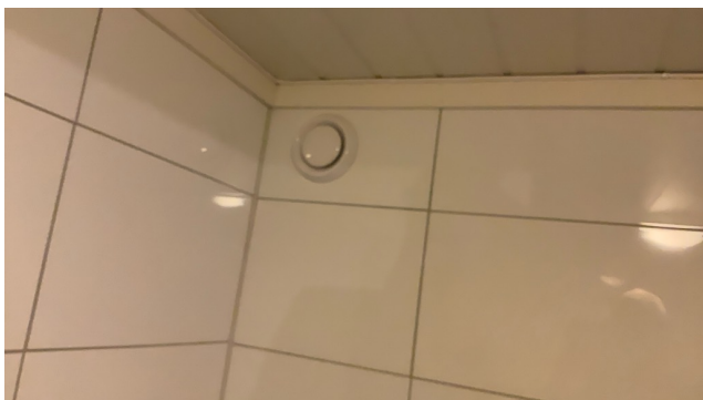
Kun naturlig ventilering på våtrom.
