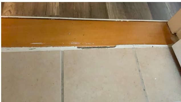
Eksempel på manglende silikon.
