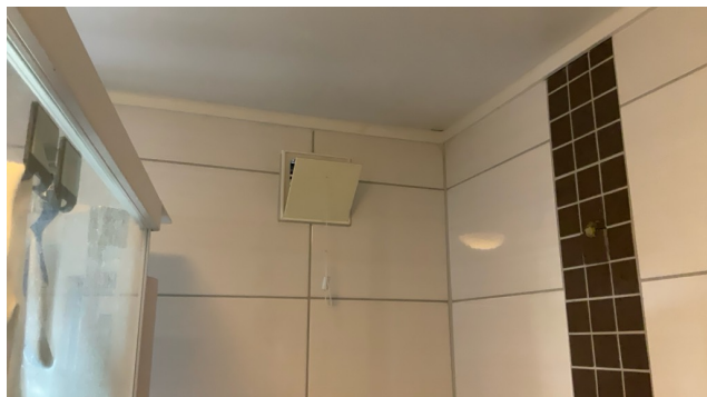
Naturlig avtrekk på våtrom.
