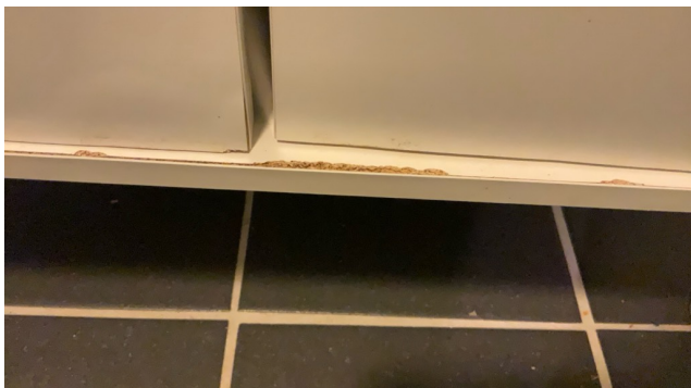
Svellskader på innredning.
