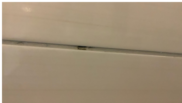
Sprekk/mangel på fugemasse i våtsone.
