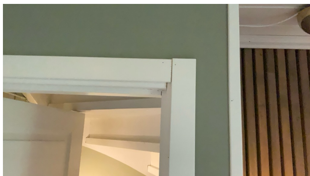
Eksempel på ufagmessig utførelse på lister rundt dør.
