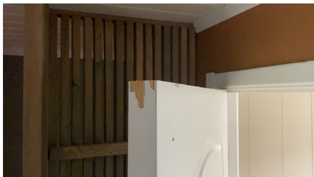
Skade på innerdør.
