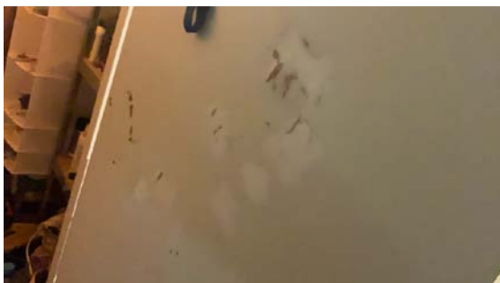
Skader på innerdør.
