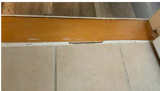
Eksempel på manglende silikon.
