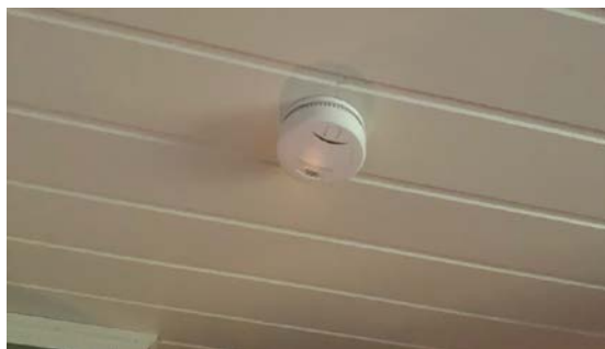
Røykvarsler i 1 etasje.
