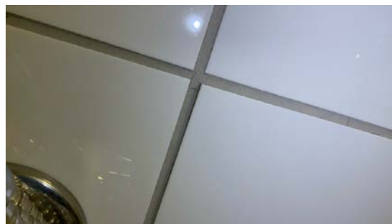
Riss/sprekker i flisfuger i våtsone.
