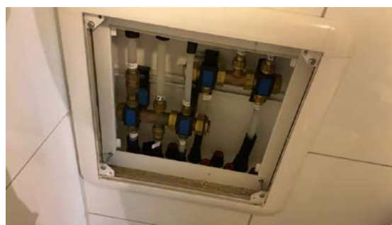
Besiktet i fordelerskap til vannrør.
