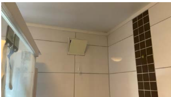
Naturlig avtrekk på våtrom.
