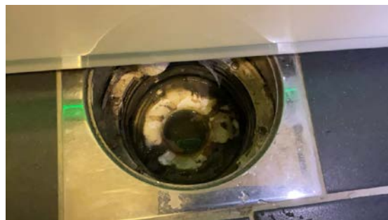
Plastsluk uten synlig slukmansjett under klemring.
