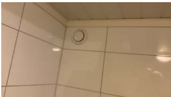
Kun naturlig ventilering på våtrom.
