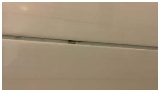
Sprekk/mangel på fugemasse i våtsone.
