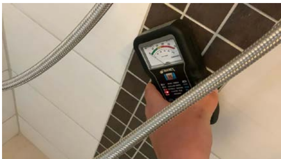
Fuktindikator gir ingen unormale resultater på vegg.
