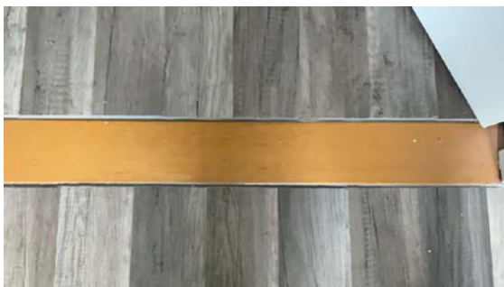
Eksempel på ufagmessig utførelse.
