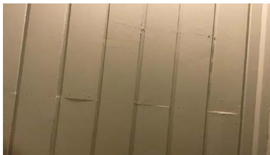
Eksempel på veldig synlige skjøter på vegg i trappegang
