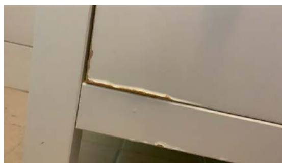
Eksempel på svelling i baderomsinnredning.
