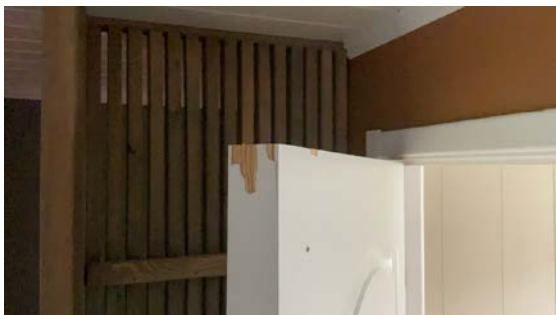
Skade på innerdør.
