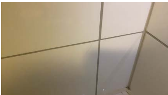
Riss/sprekk i flis i våtsonen.
