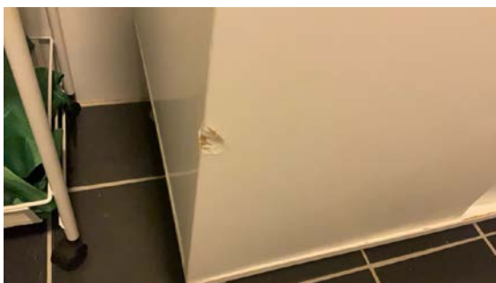
Skade på innredning.
