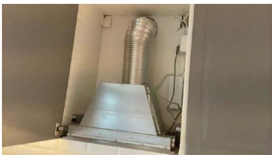
Ventilator med avtrekk ut.
