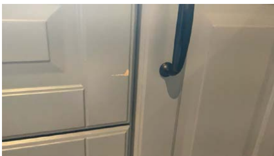
Skade på kjøkkenfront.
