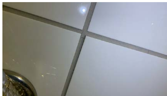
Riss/sprekker i flisfuger i våtsone.
