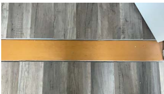
Eksempel på ufagmessig utførelse.
