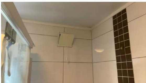
Naturlig avtrekk på våtrom.
