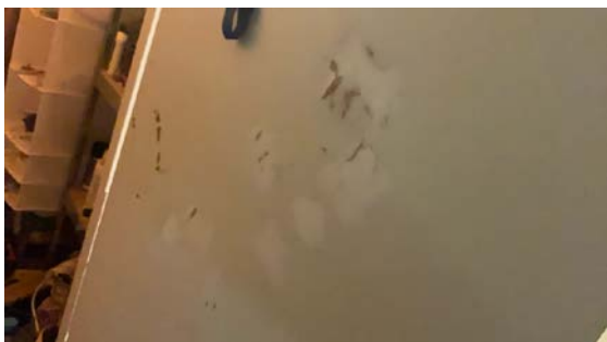
Skader på innerdør.
