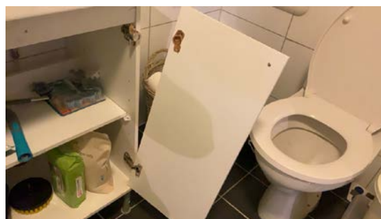
Dør på innredning defekt.
