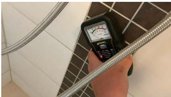
Fuktindikator gir ingen unormale resultater på vegg.
