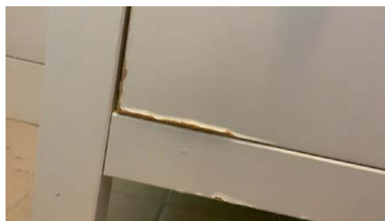
Eksempel på svelling i baderomsinnredning.
