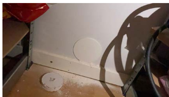
Hull forsvarlig plombert.
