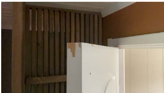
Skade på innerdør.
