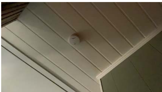
Røykvarsler i 2 etasje.
