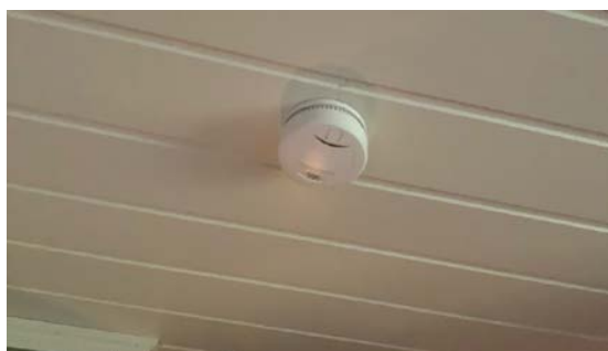
Røykvarsler i 1 etasje.
