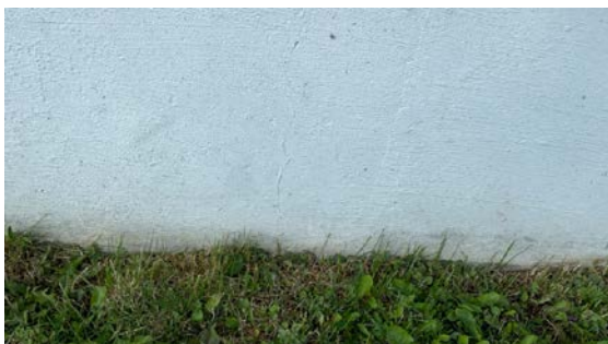
Eksempel på sprekkdannelser i grunnmur.
