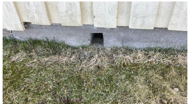
Ventilåpning mot kryprom nær terreng. Fare for innsig av vann ved snøsmelting og ved kraftig regnskyll.
