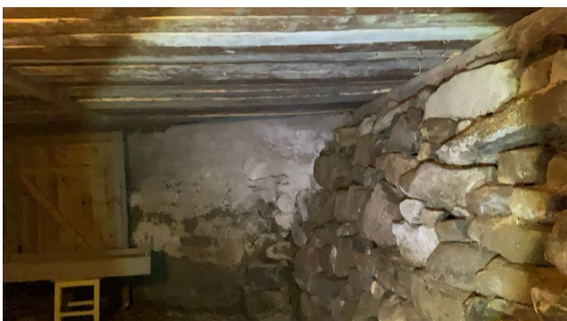
Tegn til fuktpåvirkning i vegger og i himling.
