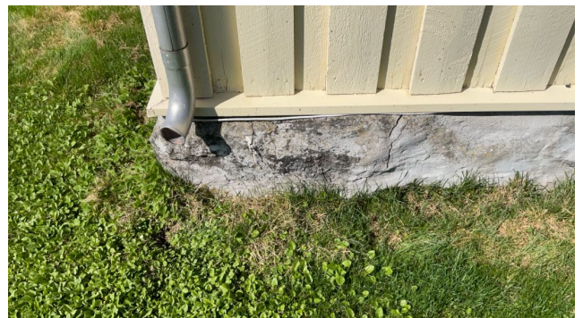
Sprekk i grunnmur.
