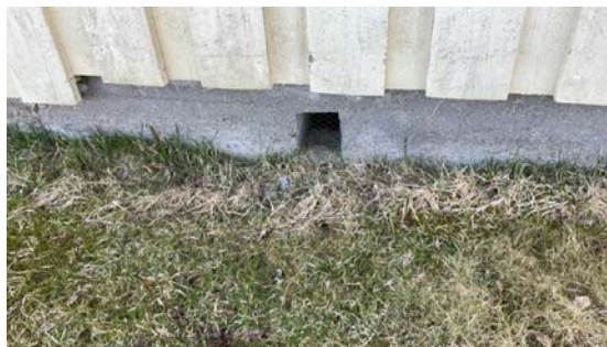
Ventilåpning mot kryprom nær terreng. Fare for innsig av vann ved snøsmelting og ved kraftig regnskyll.
