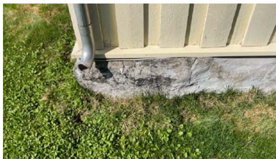
Sprekk i grunnmur.
