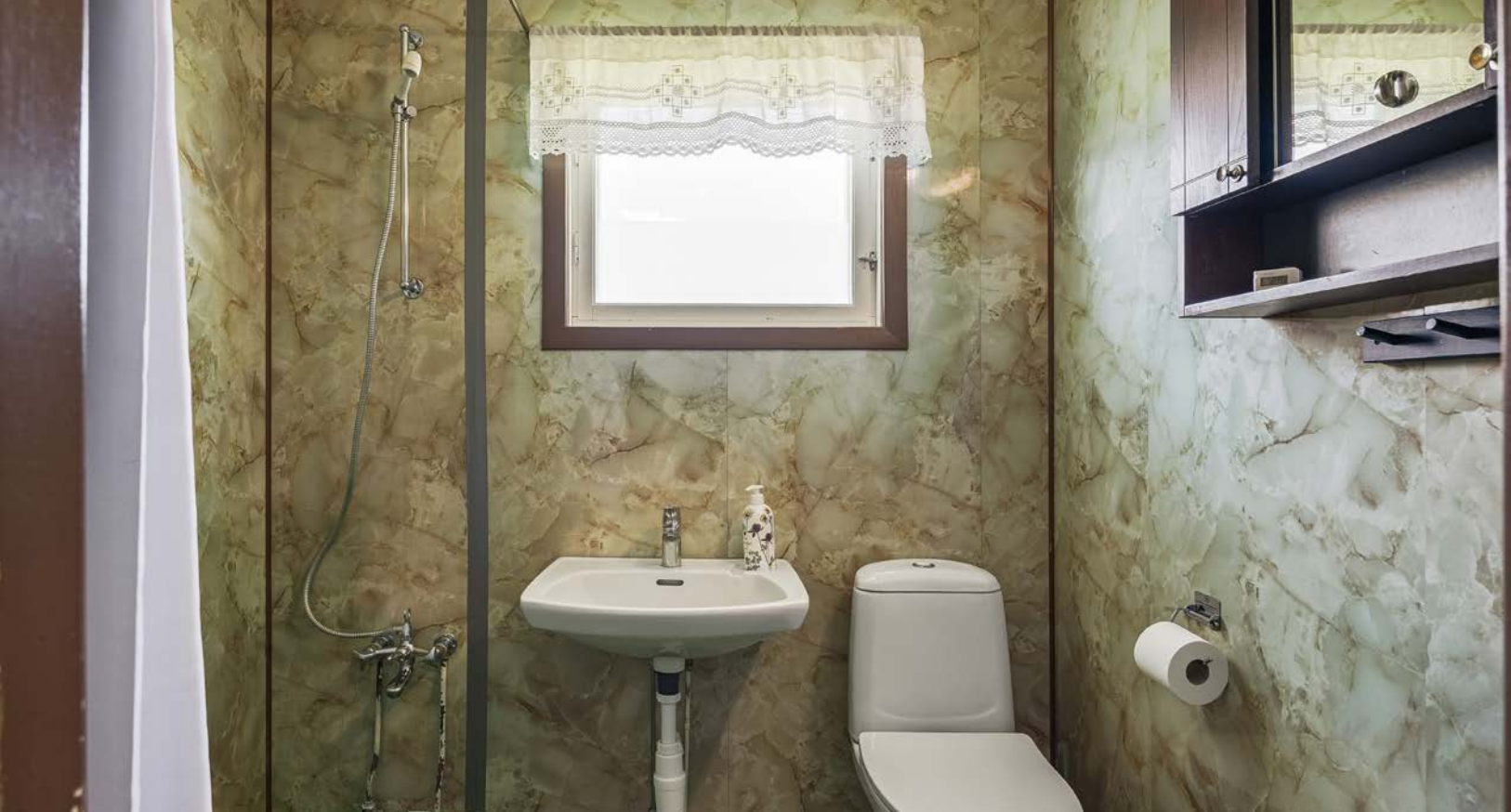
Fra entréen er det adkomst til et eldre baderom som har fått TG3 og må renoveres.
