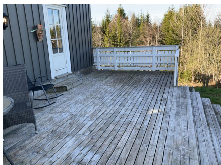
Konstruksjoner/overflater har vedlikeholdsbehov.
