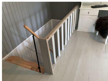
Det må gjøres tiltak med rekkverket for å lukke avvik.
