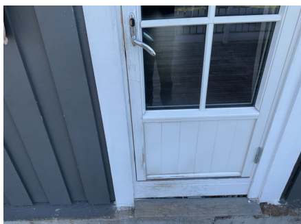
Dørene er værslitte utvendig og det er sprekker i treverket.
