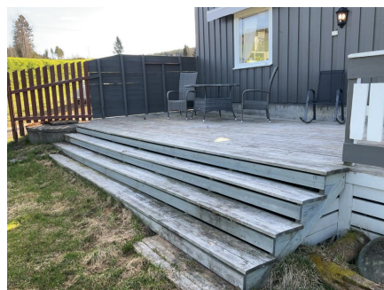
Terrassen har store skjevheter.
