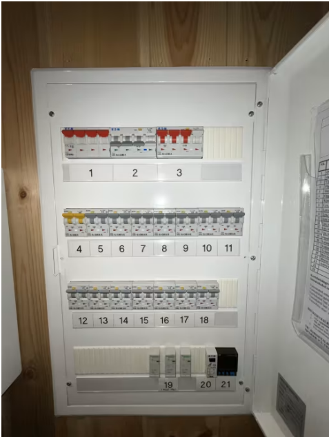
Viser sikringskap plassert i garderobe.
