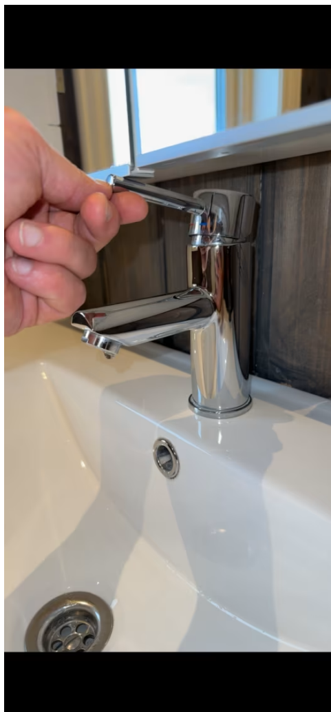
Kranen kan ikke åpnes i full stilling pga at skap er montert for tett. Gjelder begge våtrom.
