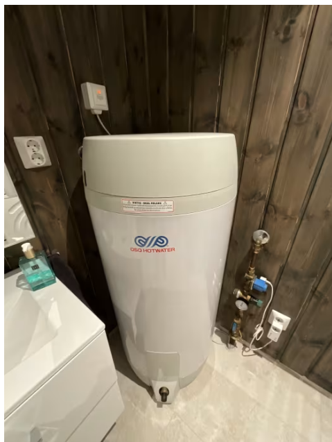
Viser bereder plassert på bad.
