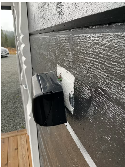
Viser løs utekontakt. Opplyst utbedret før salg.
