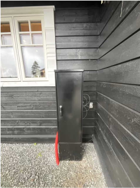
Viser utvendig inntakskap med måler. Rødt trekkerør med mulighet for å trekke strøm til garasjen.
