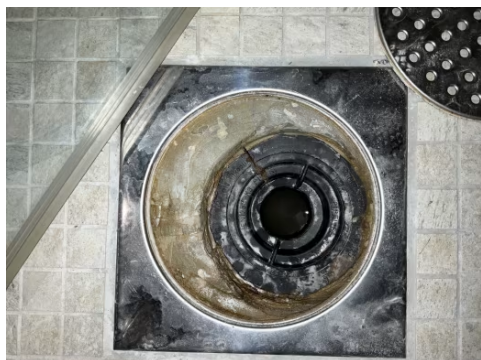
Viser sluk i dusjsonen. Klemring er ikke synlig.
