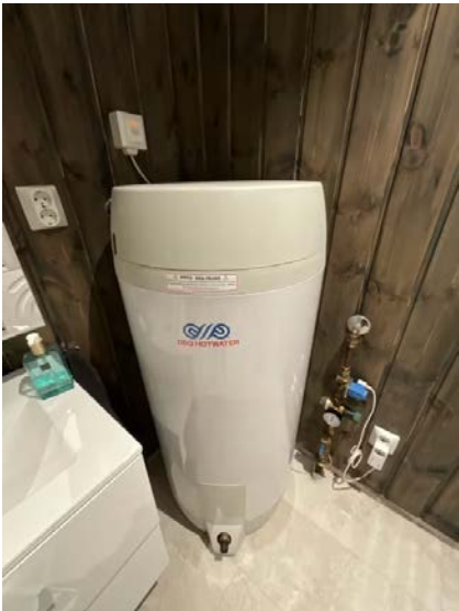
Viser bereder plassert på bad.
