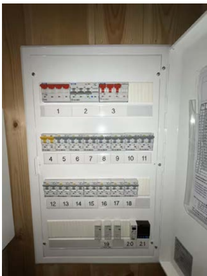
Viser sikringsskap plassert i garderobe.
