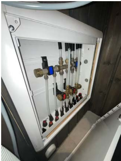
Vannrør med rør i rør system fra fordelerskap plassert på bad og frem til sanitærinstallasjoner på baderom og kjøkken.
