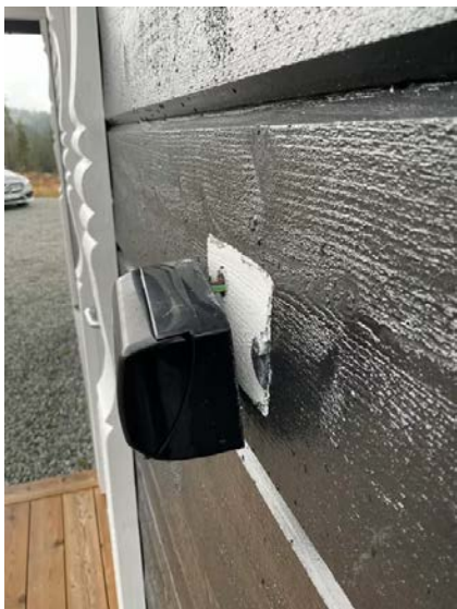
Viser løs utekontakt. Opplyst utbedret før salg.
