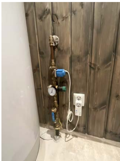
Viser vanninntak, hovedstoppekran og vannstopper plassert på bad.
