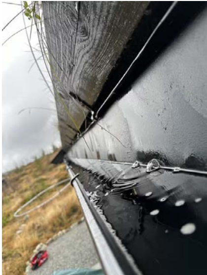
Synlig tett takrenne ved platting. Takrenner må renses for å sikre god avrenning. Det registreres torv i takrenner.
