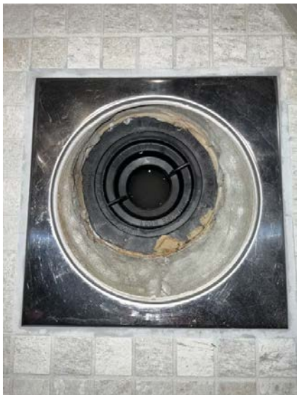
Viser sluk i dusjsone. Klemring er ikke synlig for inspeksjon.
