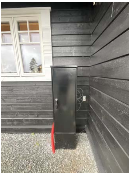
Viser utvendig inntakskap med måler. Rødt trekkerør med mulighet for å trekke strøm til garasjen.
